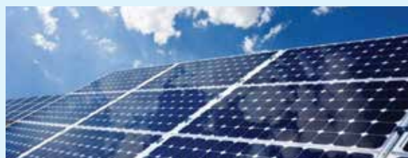
Dự án: Nhà máy điện mặt trời Cam Lâm, Xã Cam An Bắc, Huyện Cam Lâm, Tỉnh Khánh Hòa Project: Cam Lam Solar Power Plant - Cam An Bac Commune, Cam Lam District, Khanh Hoa Province
